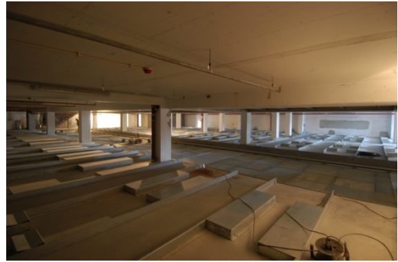
Fig. 19 - S'A & Luís Pedra e Silva Arquitectos, fotografia piso tipo estacionamento automático - Obra, 2003
